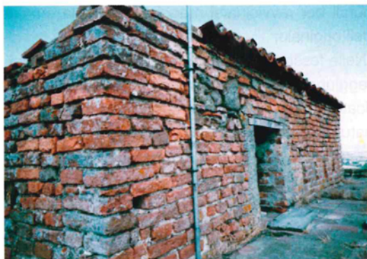
Figura 12: copertura della Torre, prima del restauro.
