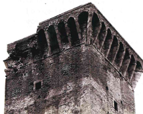
Figura 7: stato di degrado dei beccatelli della Torre.
